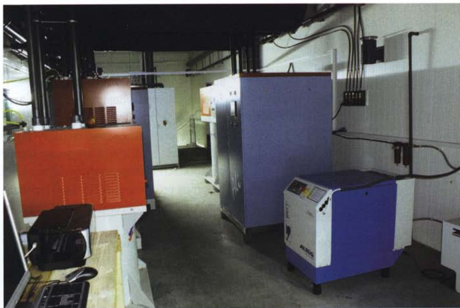
Fot. 42. Generator azotu typu PSA
